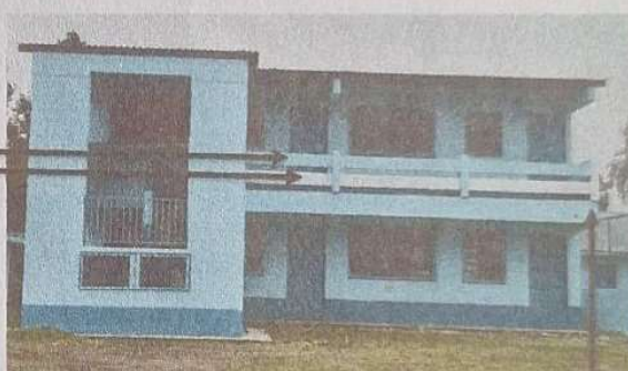
Foto 10: Repello en barandales, módulo II.
